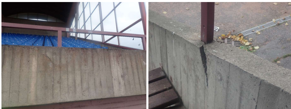
Kuvat 4 ja 5. Katsomon kaiteen teräsrakenteiden kiinnitykset betonin sisällä ovat ruostuneet ja vaurioittaneet betonirakennetta. Kaidetolppien kohtia betonirakenteessa on havaintojen mukaan paikoin paikkakorjattu. Paikkaukset ovat paikoin halkeilleet / lohkeilleet uudelleen.
