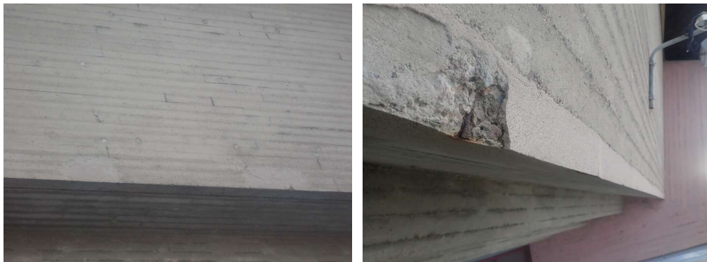
Kuvat 15 ja 16. Katsomon sisäänkäynti puolella havaittiin katsomon "takaseinässä" yksittäisiä betonin vaurioita seinän alareunassa. Kuvassa 16 olevaa kohtaa on paikattu ja paikka on vaurioitunut.
