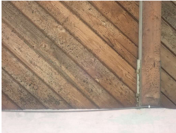
Kuva 19. Katon pinnoitteessa havaittiin tummia pilkkuja, todennäköisesti pintakäsittelyn vaurioitumisesta.
