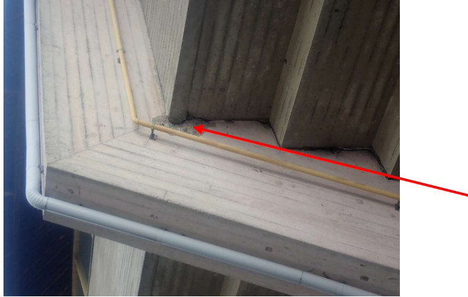
Kuva 17. Pileri-palkkirakenteessa havaittiin ainoastaan yksittäinen betonin vaurio.
