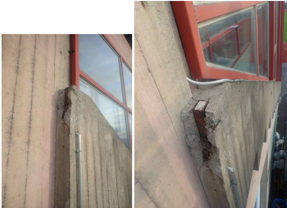
Kuvat 2 ja 3. Katsomon päätyrakenteen "kaide" rakenteesta on todennäköisesti katkaistu vanha teräsrunkoinen kaide pois ja kaiteen kiinnityskohdat ovat jääneet betonirakenteen sisään. Ruostunut teräsputki on vaurioittanut ympärillä olevan betonin.
