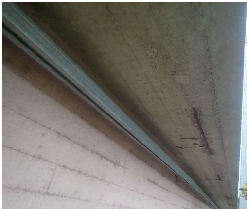
Kuva 8. Katsomon/kaiteen alapinnalla betonirakenteen pinnassa havaittiin ruostuneita teräksiä.
