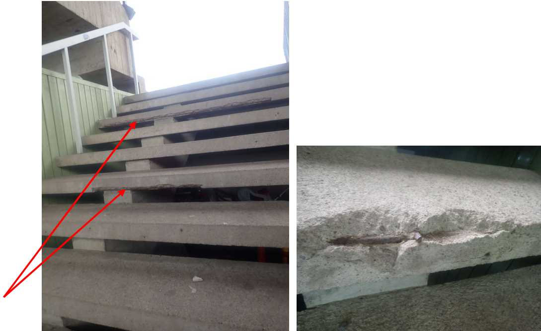
Kuvat 13 ja 14. Porrasaskelmilla on reunoilla havaittavissa betonin vaurioita.
