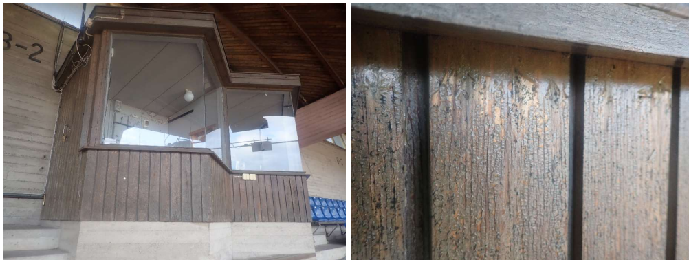
Kuvat 20 ja 21. Katsomon selostamokopin puuosien pinnoitteet ovat kuluneita ja pinnoitteessa on samankaltaisia täpliä kuin kattolaudoissa.
